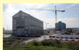
Vue de la construction du bâtiment du Frac, sur le site des ACP, avenue des Bancs de Flandres à Dunkerque.
